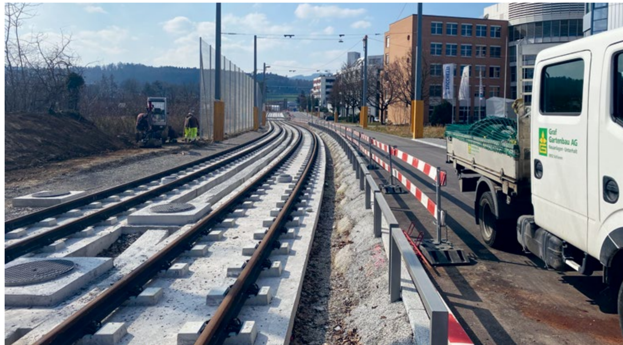
Die Limmattalbahn-Baustelle schreitet weiter voran und die Gleise nehmen langsam Form an. Foto: Präsidialabteilung
